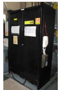
駆動装置・制御盤
