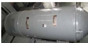
電動機発電機
